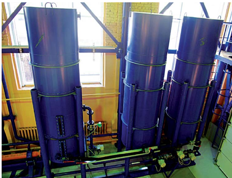
Рис. 4. Стенд ГЖС, блок подготовки рабочей жидкости
