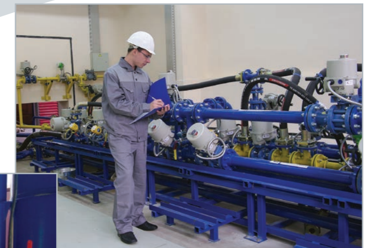
Стенд ГЖС «Манifold» – узел управления газожидкостной смесью в процессе испытания
